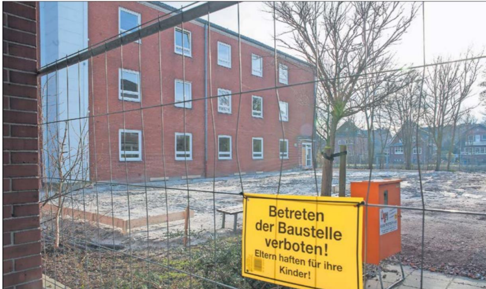
Trakt 200 der Integrierten Gesamtschule: Die Tiefgründung für den dreistöckigen Anbau ist bereits erledigt. Zurzeit wird die Statik der Fundamente extern überprüft. EZ-Bilder: Hasseler
