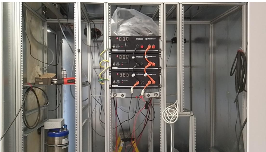
Abb. 1 Wasserstoffcontainer mit eingebauten Batterien
